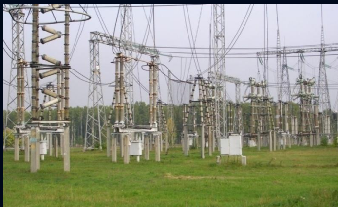
Общий вид оборудования на открытых распределительных устройствах 500 кВ
