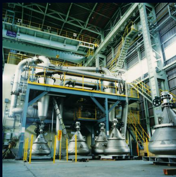
Охлаждающий контур в системе рециркуляции газа большой распылительной установки
